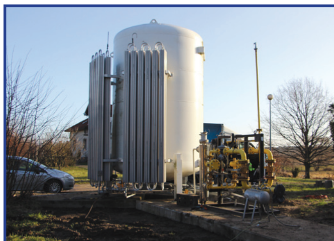
Stacja LNG to skroplony gaz ziemny wysokometanowy zamieniony w postać płynną w celu ułatwienia transportu gazu do miejsc znajdujących się poza zasięgiem tradycyjnych sieci gazowych.
